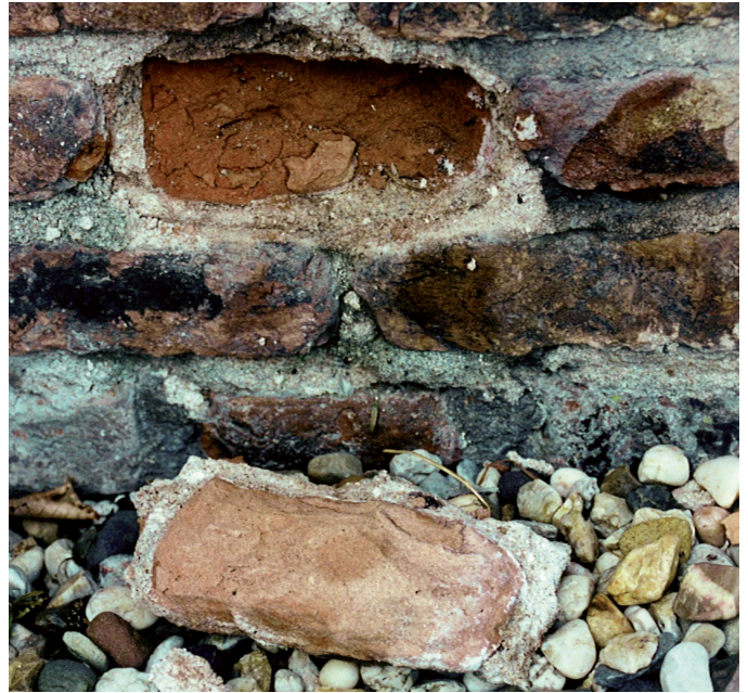
Schakel een vakbekwaam bedrijf in om te voorkomen dat de hydrofobeerlaag, zoals hier, de gevel aantast. (foto TNO-Bouw, Delft)
