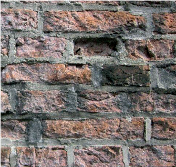
Onherstelbaar beschadigd metselwerk: verkeerd voegwerk, een witwaas op de stenen en beschadigde bakstenen door opgesloten vocht.
