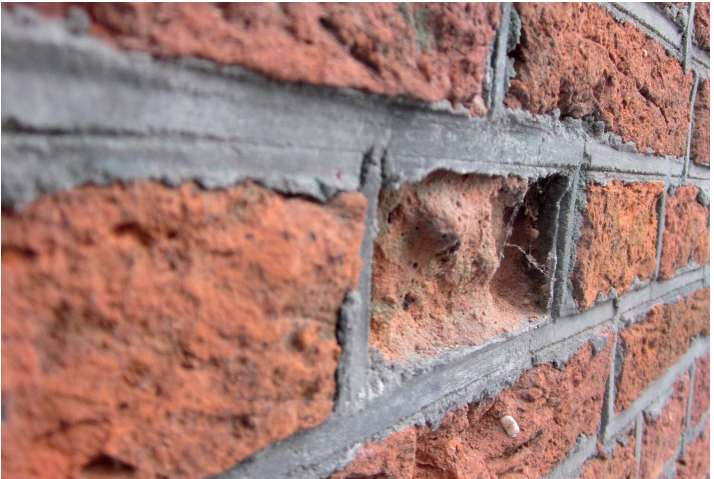
Een onherstelbaar gerestaureerde gevel: de toplaag van de baksteen is kapot gereinigd, de voegen zijn te groot uitgeslepen en gevoegd met een te harde specie, waarna door vocht en vorst deze schade is ontstaan. Herstel is niet mogelijk en de kans op toenemende schade groot. (foto Robin Zwaan)
